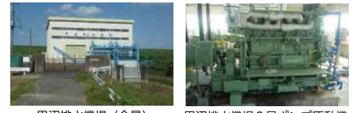
男沼排水機場(全景) 男沼排水機場2号ポンプ原動機
